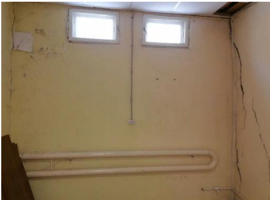
Рис. 2. Трещина в несущей стене [3]
