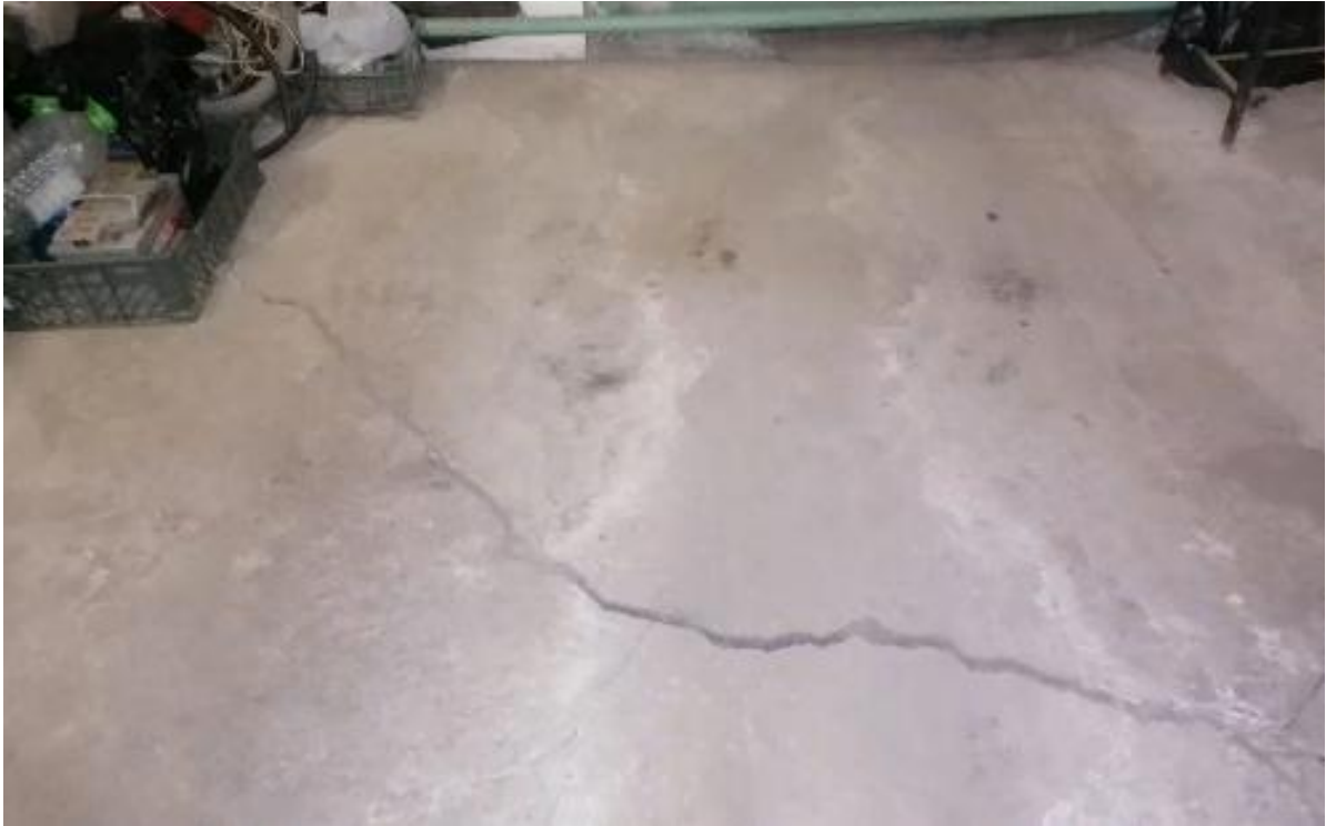
Рис. 4. Провал бетонного пола [3]
