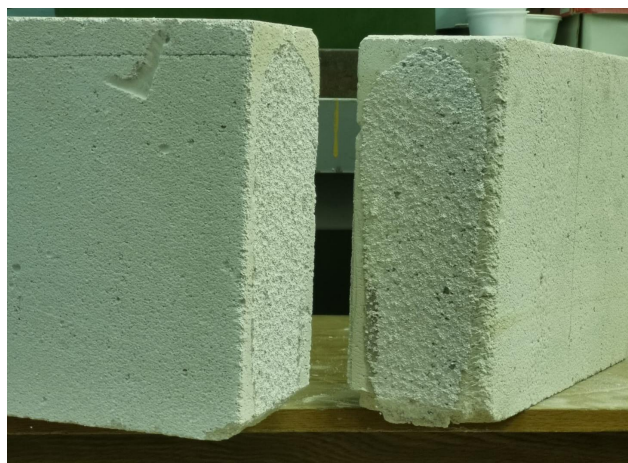
Рис. 4. Типичный вид торцов блоков после разрушения перемычки
