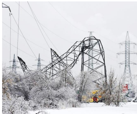
Рис. 2. Поломка металлической опоры [1]
