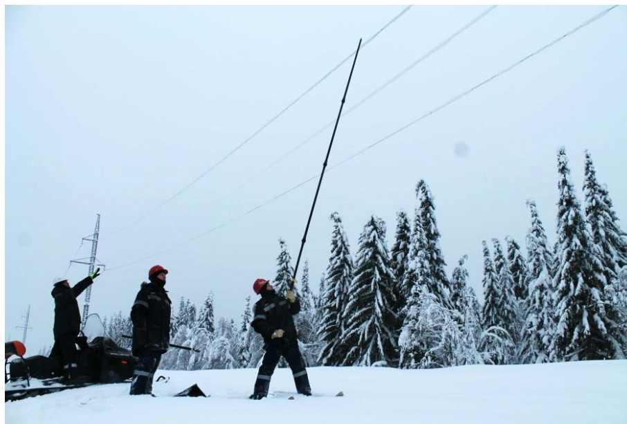
Рис. 3. Сбивание наледи с проводов ЛЭП [1]
