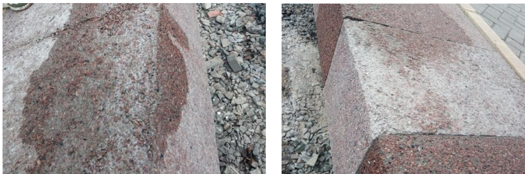
Рис. 4. Разрушение бетона под действием противогололедных реагентов
