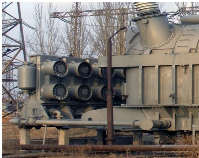
Рис. 3. Общий вид системы охлаждения трансформатора типа ДЦ
