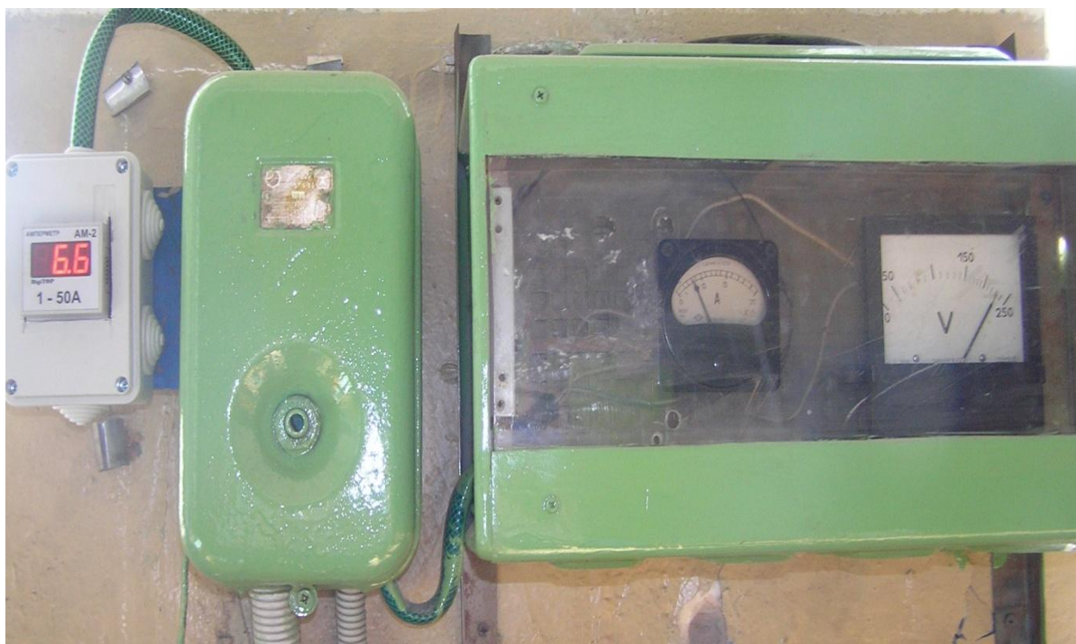
Рис. 3.5. Блок контрольных приборов
