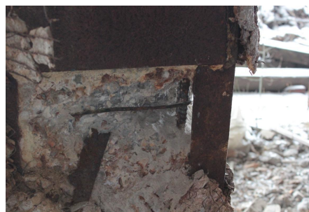
Рис. 2. Техническое состояние колонн 1-го этажа производственной зоны
