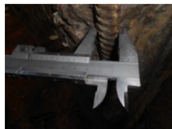
Рис. 5. Замер диаметра и фотофиксация состояния арматуры
