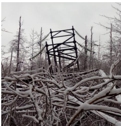
Рис. 1. Поваленная опора ВЛ 110кВ
