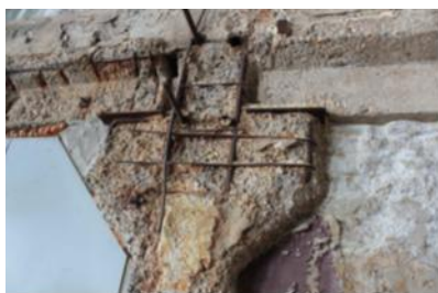
Рис. 3. Коррозия бетона и арматуры колонн 1-го этажа производственной зоны
